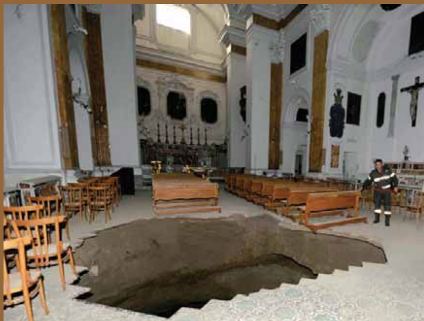
Fig. 2.3.6 - Sprofondamento presso la Chiesa di S. Carlo alle Mortelle
