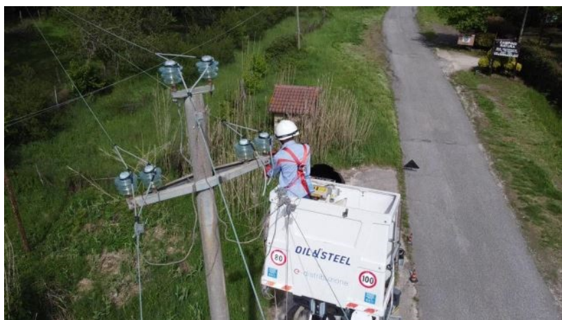
Figura 5: Messa in sicurezza delle linee per ridurre il rischio di elettrocuzione.
