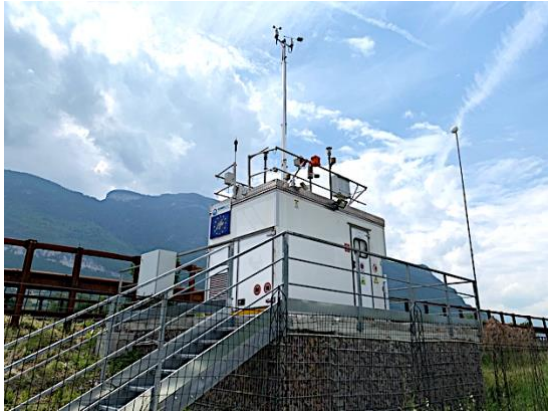
Figura 1: Stazione di misura installata a bordo autostrada
