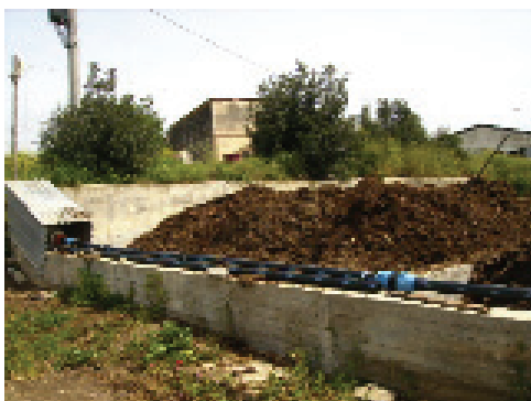
Ventilatore e tubo principale di distribuzione dell'aria.
