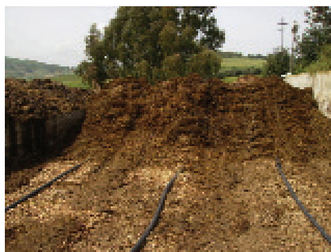
Tubi forati su letto di cippato per la distribuzione dell'aria alla base del cumulo.
