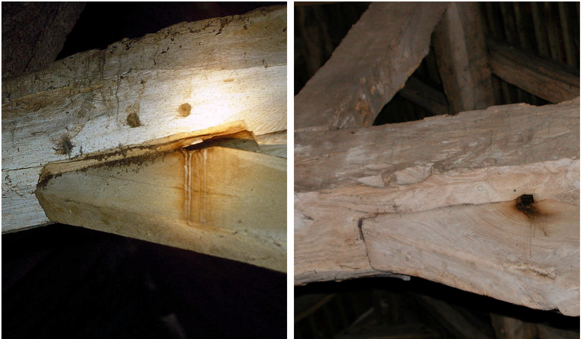
Figura 2.7 - Particolari delle congiunzioni di due travi in legno in un fienile col sistema tenone-mortasa, che forma una piccola cavità adatta al rifugio di chiroteri (da Briggs, 2004).
