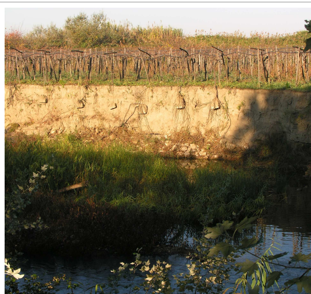
Fig. 13. Vigneto abusivo sull'argine. Foto: M. Marrese
