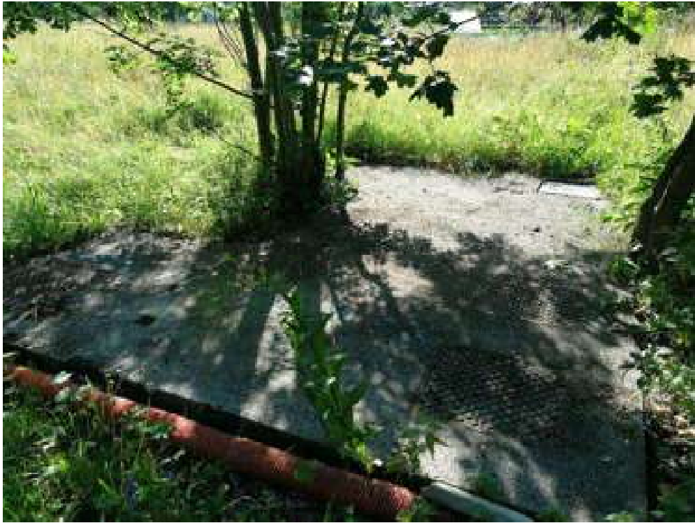
Serbatoio interrato a valle della strada – circa 30 m dal punto di allestimento vasca
