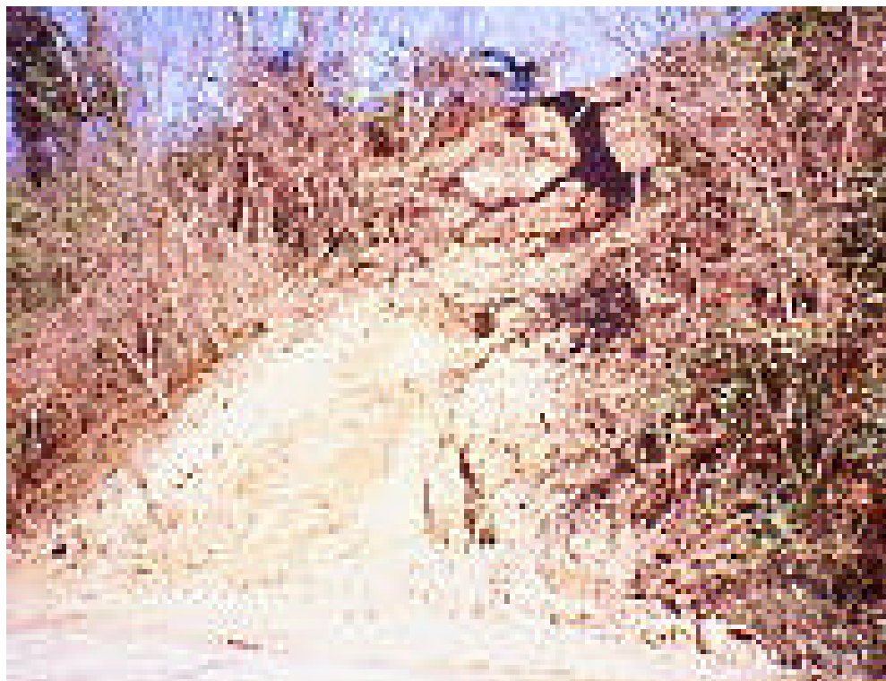
Foto 10 – Area in dissesto prima dell'intervento. Atina (FR)
