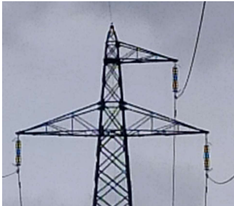
Foto 1: testa del sostegno n. 60 della linea n. 837, che si trova a nord-est dell'edificio indagato. Armamento dei conduttori in sospensione.
